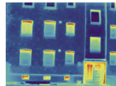
Imagen termográfica, antes de la rehabilitación. La totalidad del edificio es un puente térmico.
